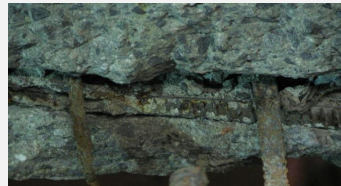
Коррозия плит настила – закрытая парковка Laurier Tache
