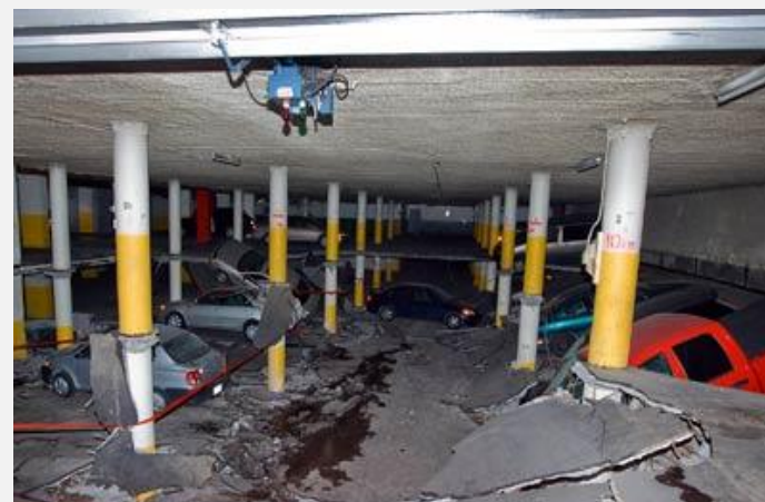
Обрушение плит перекрытий закрытой автопарковки
